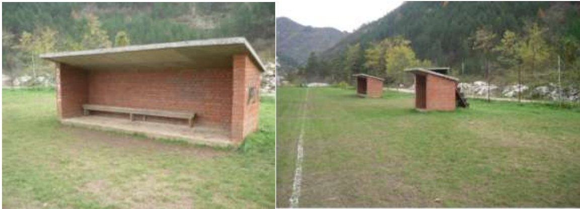
Slika 4. i 5. Izgled i stanje loža na gradskom stadionu Jablanica
